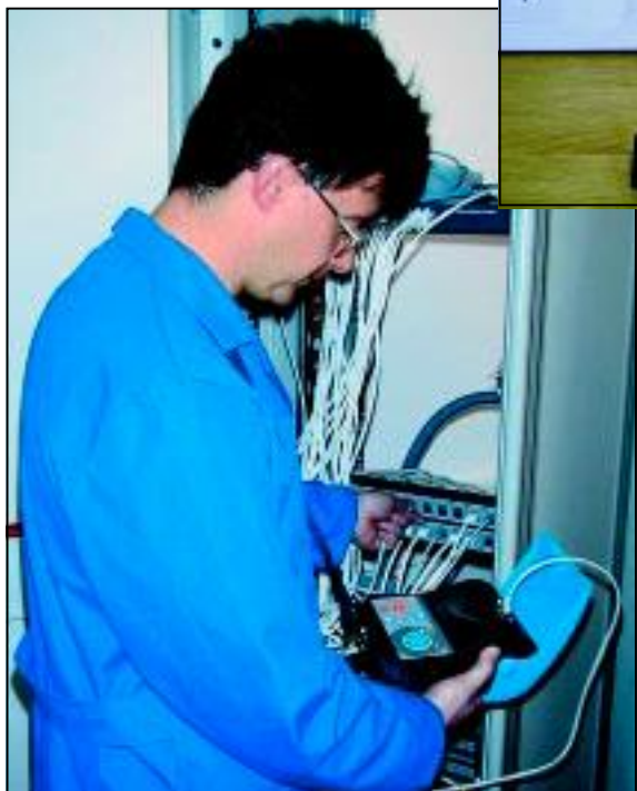
Przykład lokalizowania uszkodzeń w instalacji LAN
